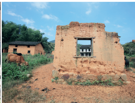
▲无人居住带来修缮的缺乏，老房子渐渐倒塌，只剩下断壁残垣。
